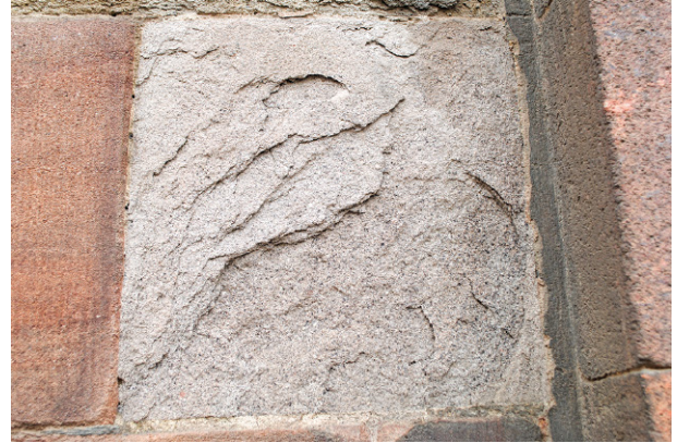
Abb. 11. Schuppen- und Schalenbildung an einem nicht lagergerecht eingebauten Werksteinblock, Katharinenkirche Zwickau.
