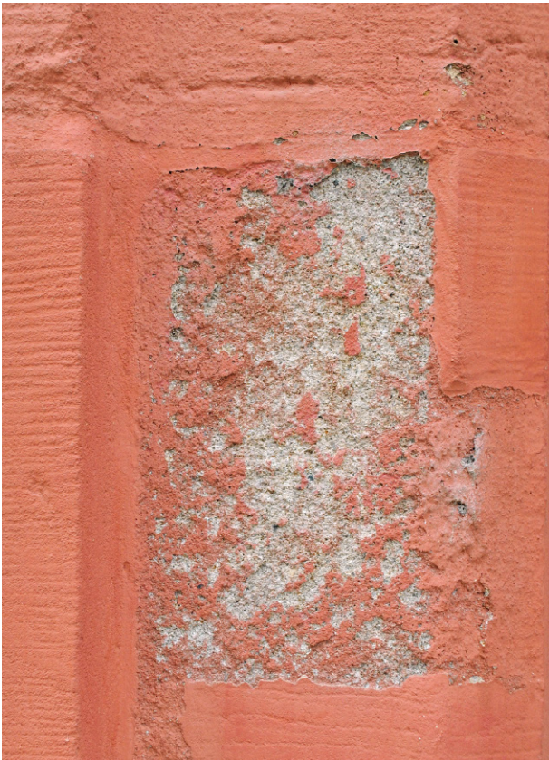
Abb. 14. Ablösende Farbschichten auf Sandstein-Oberflächen, Priesterhäuser in Zwickau.
