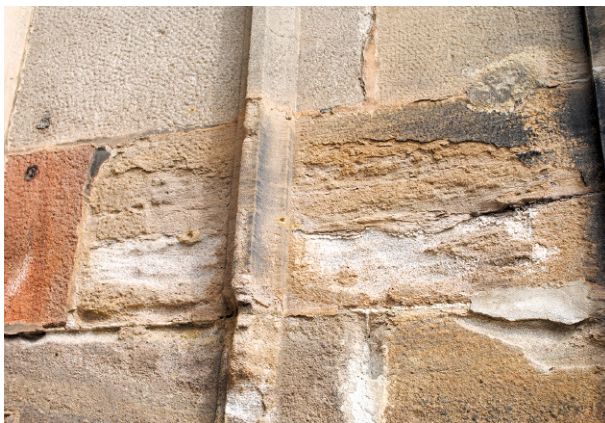
Abb. 12. Steinschäden und Salzausblühungen an der Marienkirche in Zwickau.
